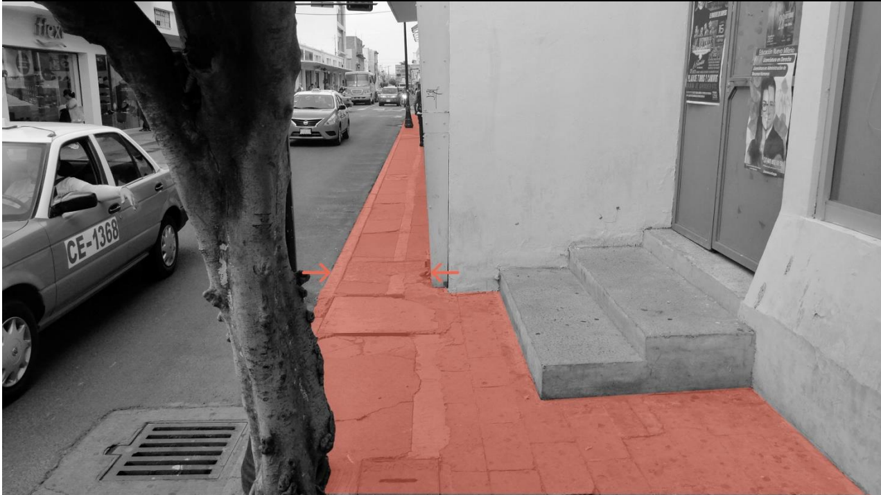
BANQUETAS CALLE MIGUEL HIDALGO Reducción de amplitud de banqueta por construcción de locales y escalones de acceso. Banquetas con parches y en malas condiciones.
